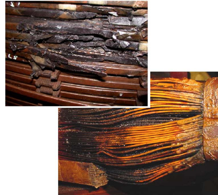
Sobrecalentamiento y daños irreparables en los transformadores de Sudáfrica en Octubre-Noviembre de 2003
