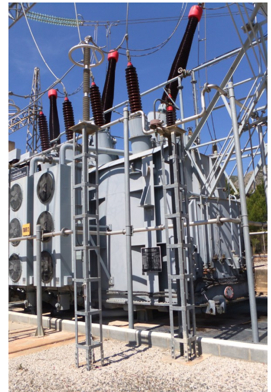
Transformador en la subestación de Vandellòs
